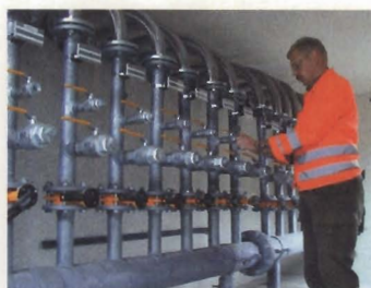
Gas-Sammelstation: Ermittlung des Methan- und Sauerstoffgehalts
